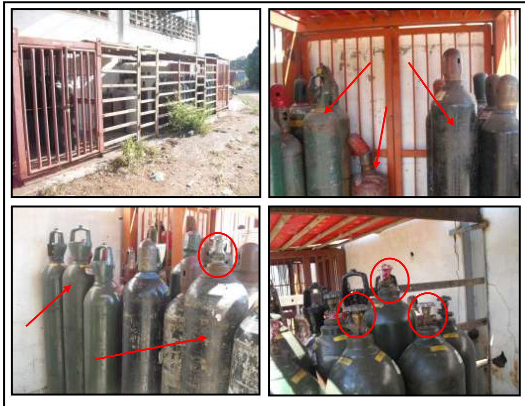
Imagen: 5.15. Almacén de bombonas Fuente: Elaboración propia
