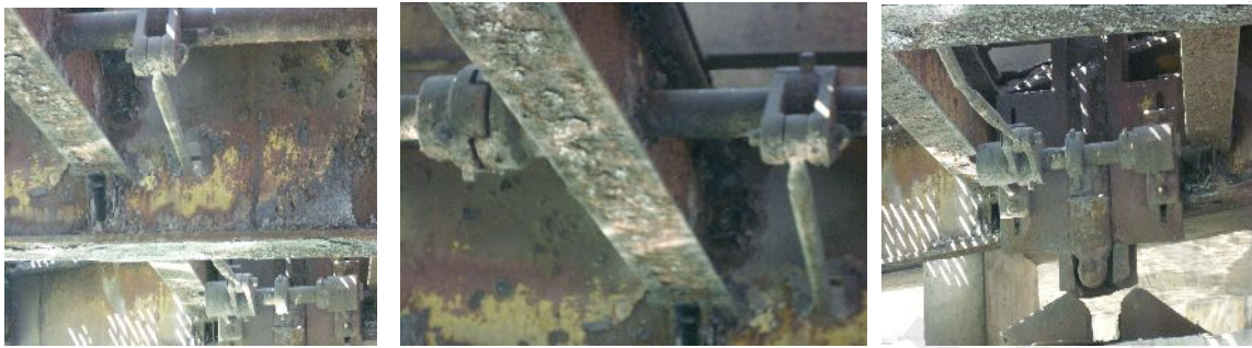
Figura 1.5 Mecanismo de transmisión hasta el cierre central en los extremos del puente.
