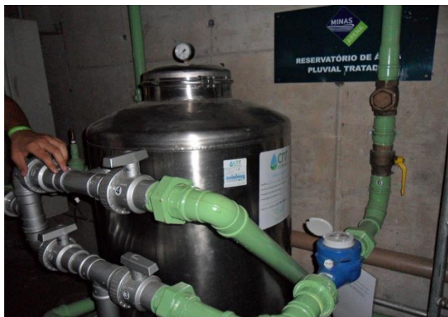
Figura 23 – Filtro para água da chuva
