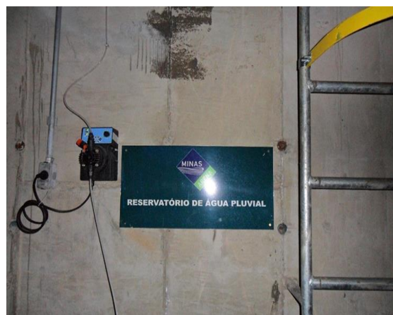
Figura 22 – Bomba dosadora de cloro
