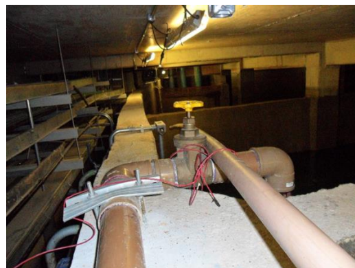
Figura 20- Registro de duto de entrada água do reservatório
