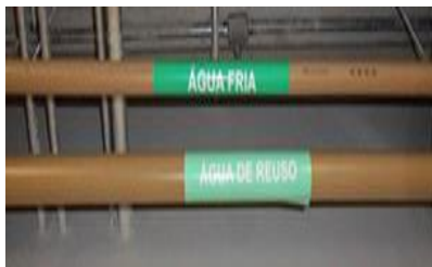
Figura 26 – Tubulação água de reuso
