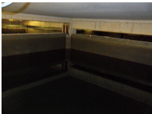
Figura 21 - Reservatórios de água pluvial
